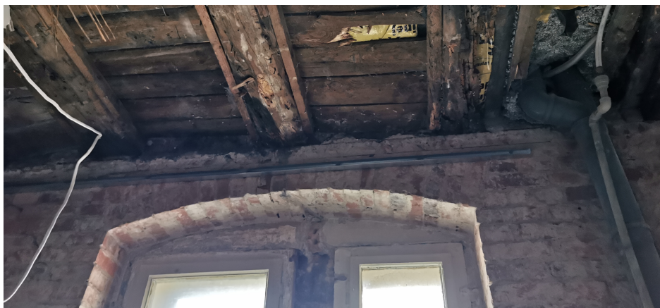
Zawilgocone belki stropowe
