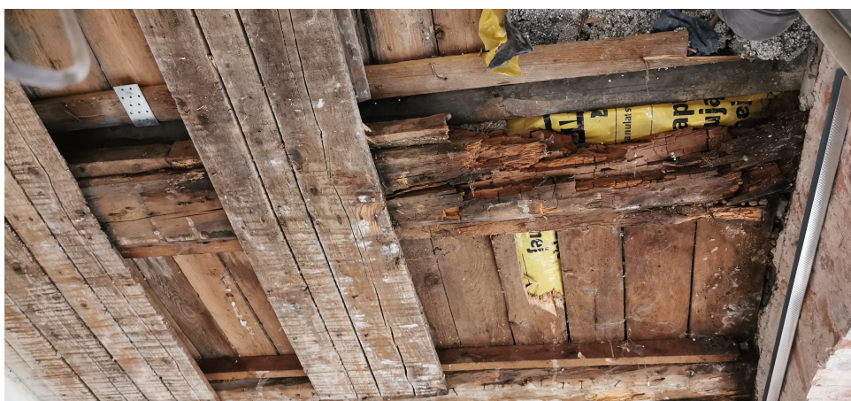
Ubytki przekroju beli stropowej
